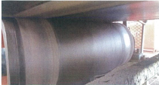
CV 107-A (Bend Pulley) No.03
