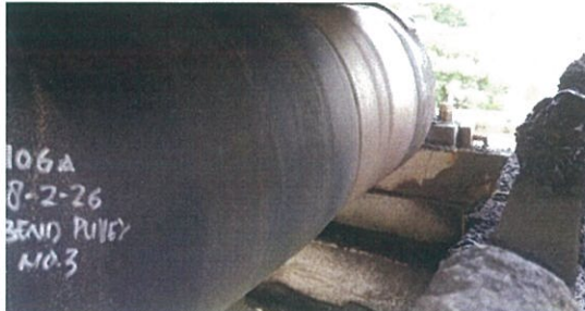
CV 106-A (Bend Pulley) No.03
