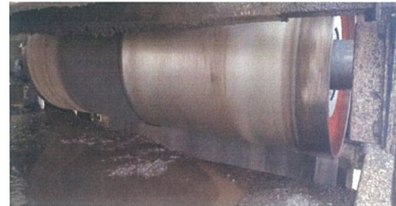
CV.108-A (Bend Pulley) No. 04
