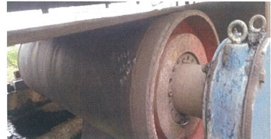
CV 106-A (Bend Pulley) No.05
